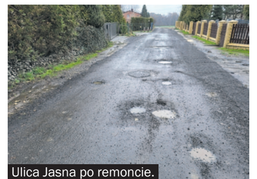
Pokruszona nawierzchnia na ulicy Przyjaźni.
