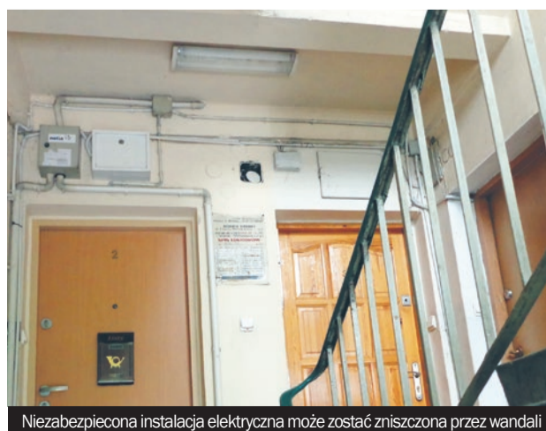
Niezabezpieczona instalacja elektryczna może zostać zniszczona przez wandalę
