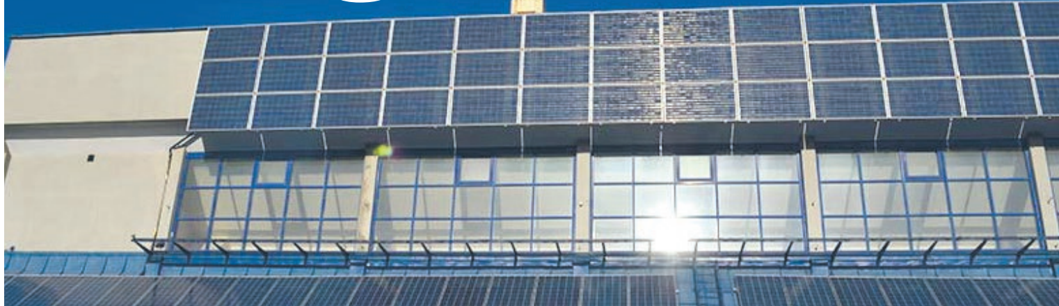
Instalacje fotowoltaiczne na dachu kościoła w Jaworznie
